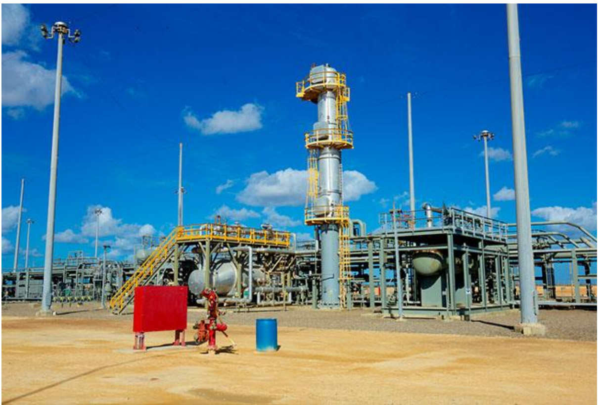
Figura 3. Planta de tratamiento de gas Natural.
