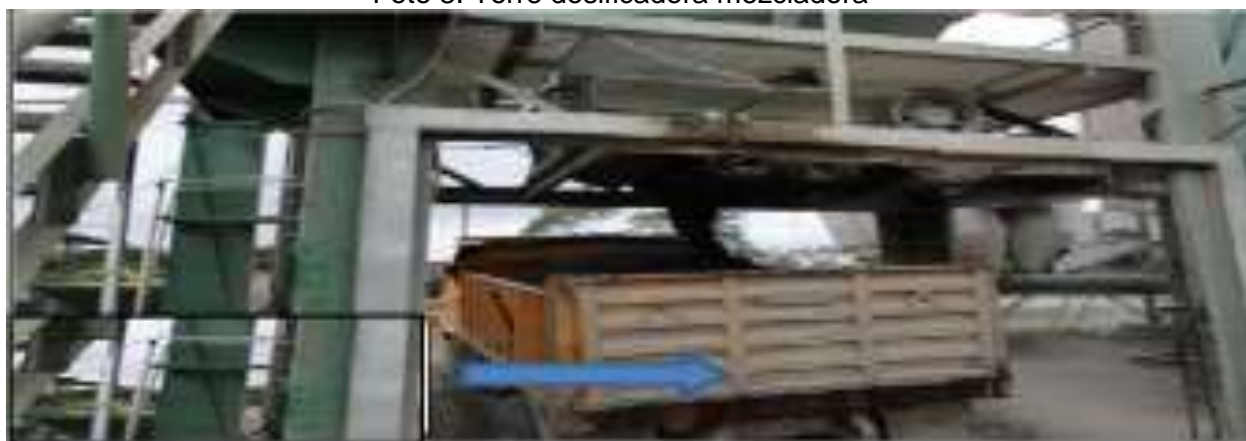
Foto 3. Torre dosificadora mezcladora
