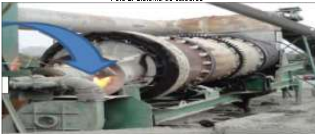
Foto 2. Sistema de calderos
