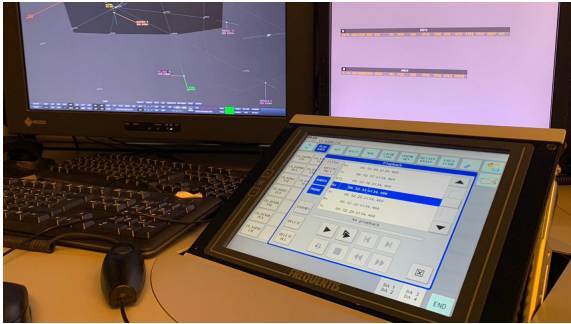
Figura 47: Ubicación Panel VCCS en la CWP [53]
