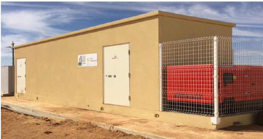
Ilustración 32: Centro de seccionamiento modelo
