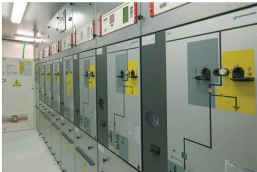
Ilustración 28: Celdas de media tensión
