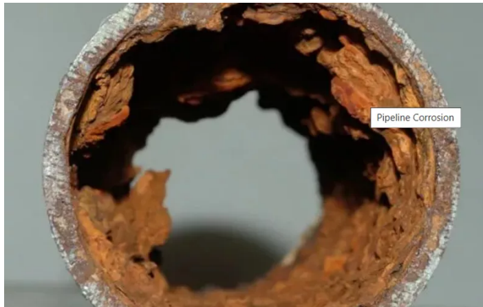
Figura 1. Proceso de corrosión típico en una tubería de Acero.
