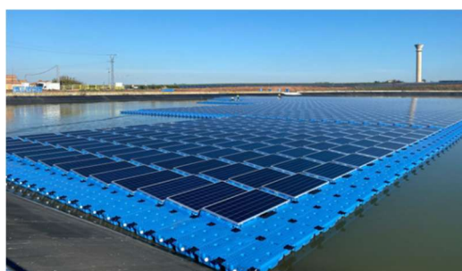
Ilustración 20: Instalación fotovoltaica flotante de Sierra Brava, Cáceres (Fuente: Isifloating).
