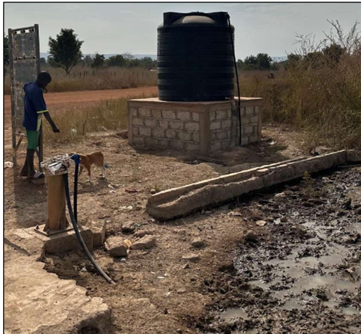
Figura 10 Pozo de bombeo con depósito. Itato
