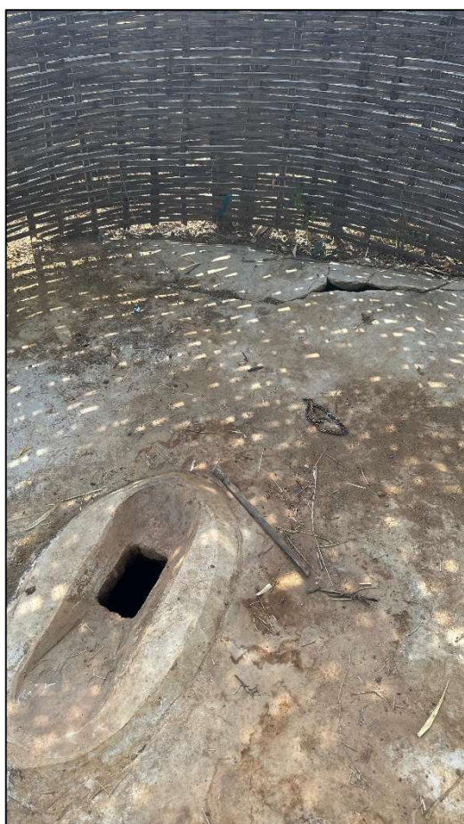
Figura 15 Letrina inutilizada por rotura de solera. Itato
