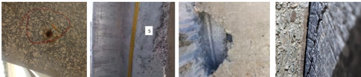
Figura 93. Patologías típicas de tuberías de hormigón. XI Ed. Curso Postgrado 2025. Especialista en tecnologías sin zanja. IBSTT.
