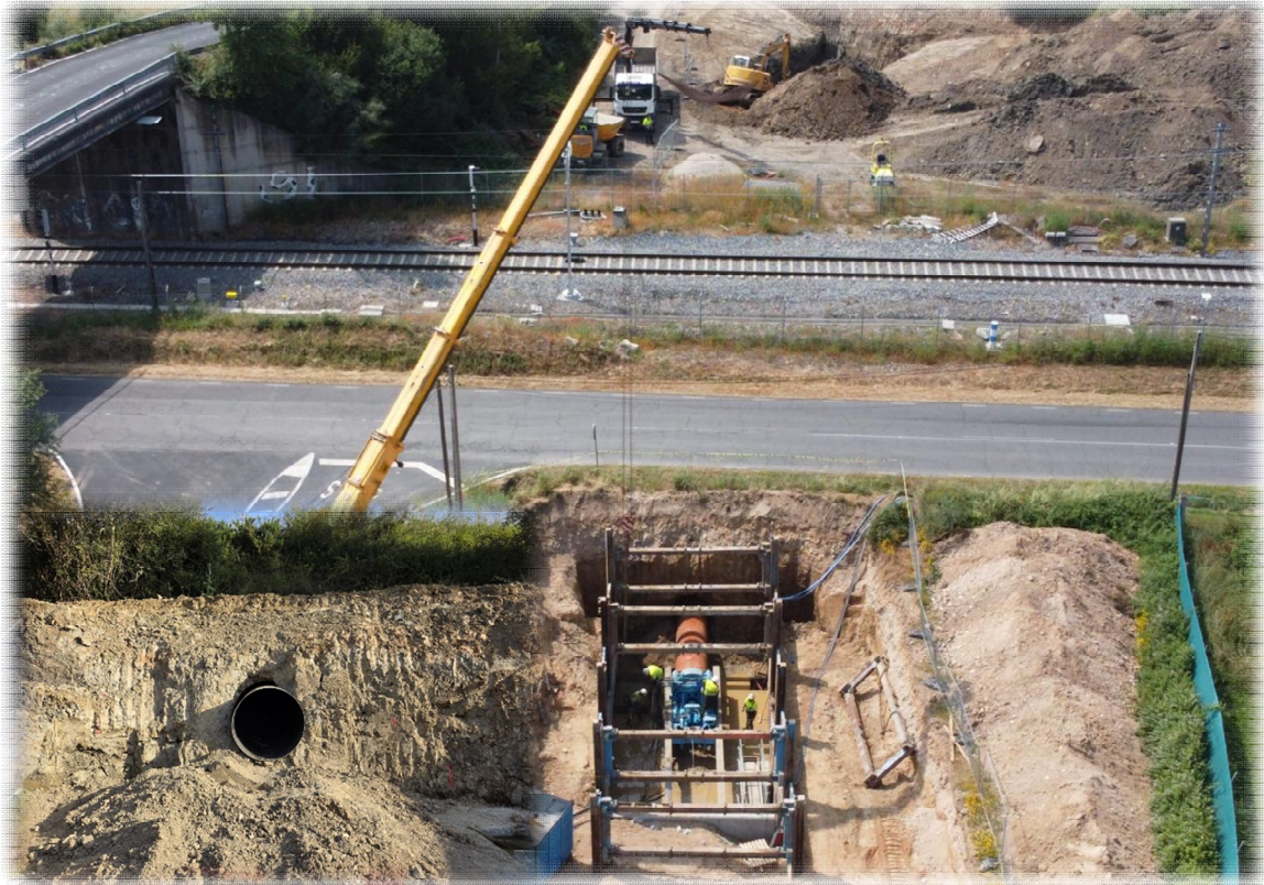
Figura 95. Vista área de cruce bajo FCC y vial en suelo cohesivo. Tubería de acero. Fuente propia.2025.
