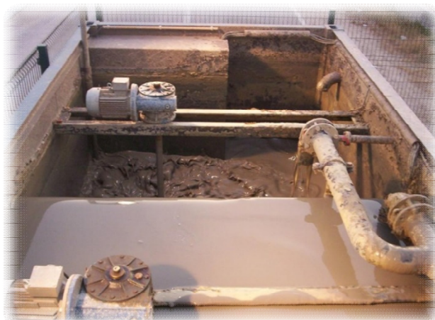
Figura 48. Centro de bombeo de lodos. XI Ed. Curso Postgrado 2025. Especialista en tecnologías sin zanja. IBSTT.
