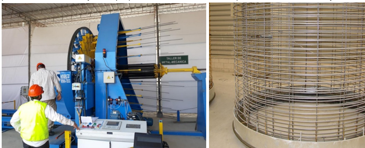
Figura 88. Proceso de disposición de armadura para tubo hincado. XI Ed. Curso Postgrado 2025. Especialista en tecnologías sin zanja. IBSTT.
