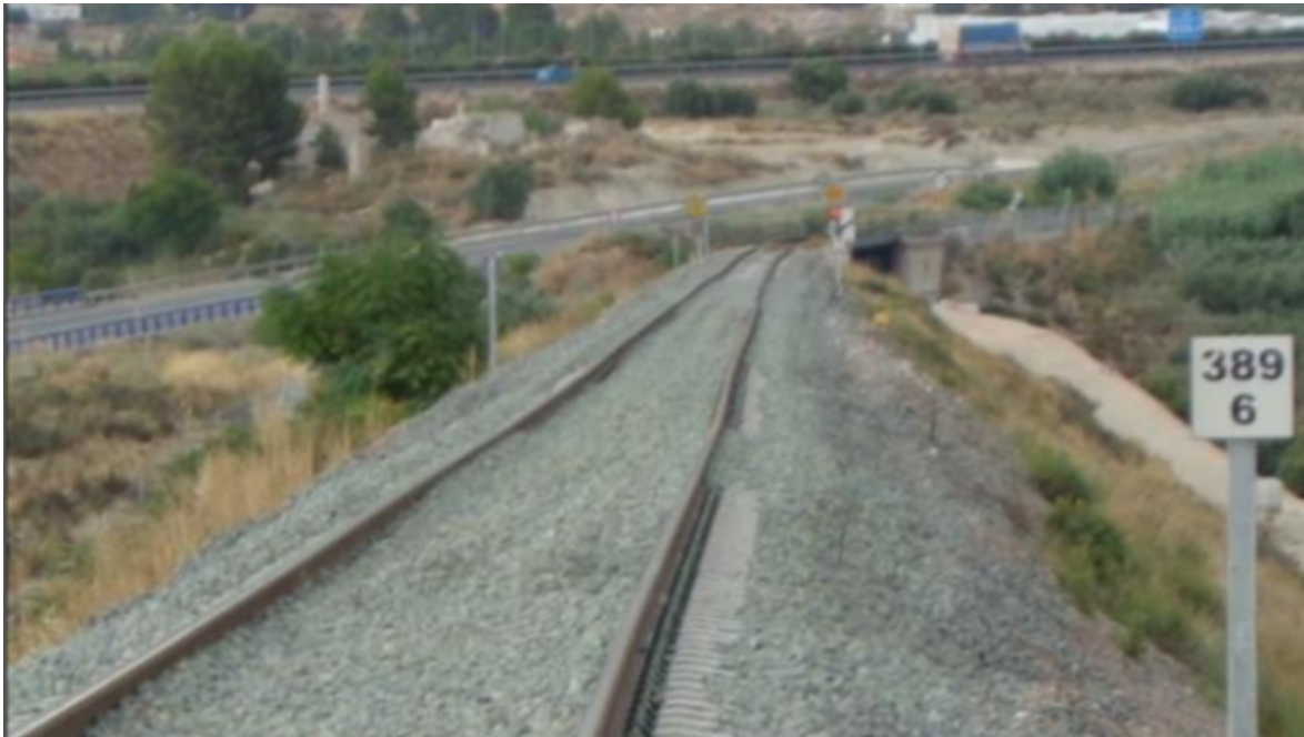
Figura 153. Estado y defectos de la vía debido al embolsamiento de agua. Fuente propia.
