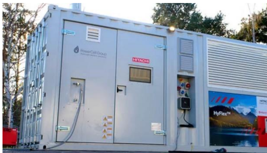
Ilustración 95 Grupo electrógeno Hitachi de 600kVA funcionando a hidrógeno [137]
