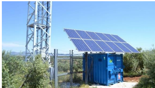
Ilustración 94 Panel solar y GEL alimentando una antena de telecomunicaciones [140]
