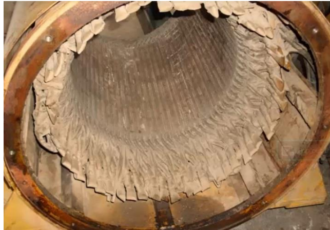
Ilustración 70 Devanados sucios y en mal estado [105]
