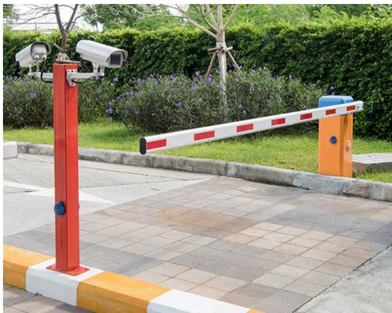
Figura 3.2: Barrera automática y cámaras. De adfabsgates.co.uk .
